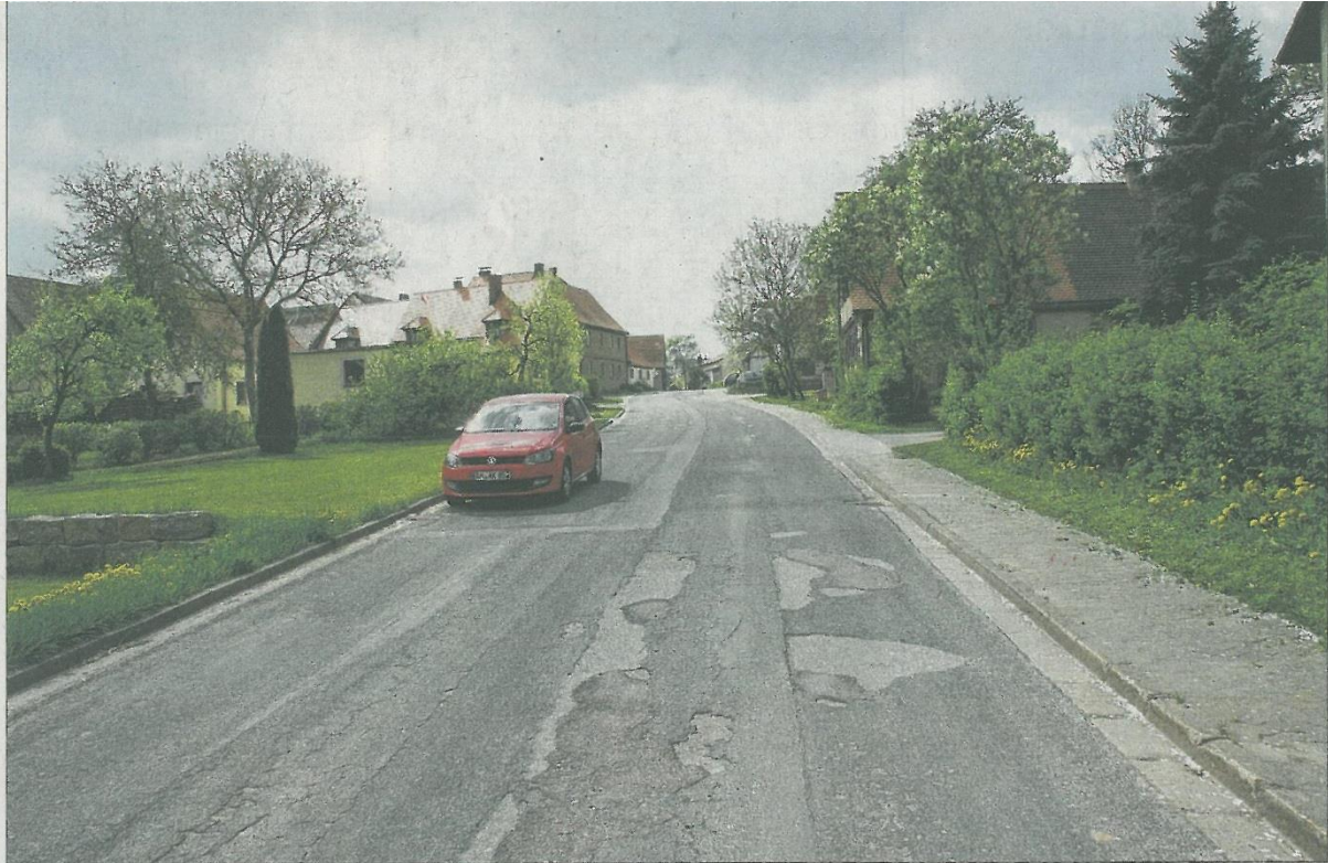
Idylle mit schadhafter Dorfstraße: Dieses Bild bot sich gestern in dem Dorf Hornau. Weil das günstigere von nur zwei Angeboten „als unangemessen hoch“ eingestuft wurde, wird die Ortsdurchfahrt nun zunächst nicht saniert. Fotos: Güner
