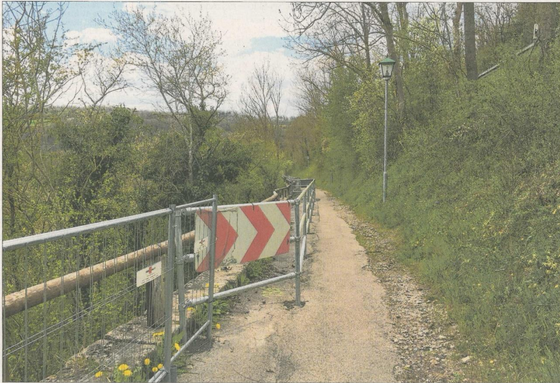
Links ein Metallzaun vor der alten Mauer, rechts bröckelnder Weg: So sieht die Lange Steige, die von der Stadt hinunter ins Tal Richtung Detwang führt, derzeit aus. Radler müssen absteigen. Foto: Clarissa Kleinschrot
