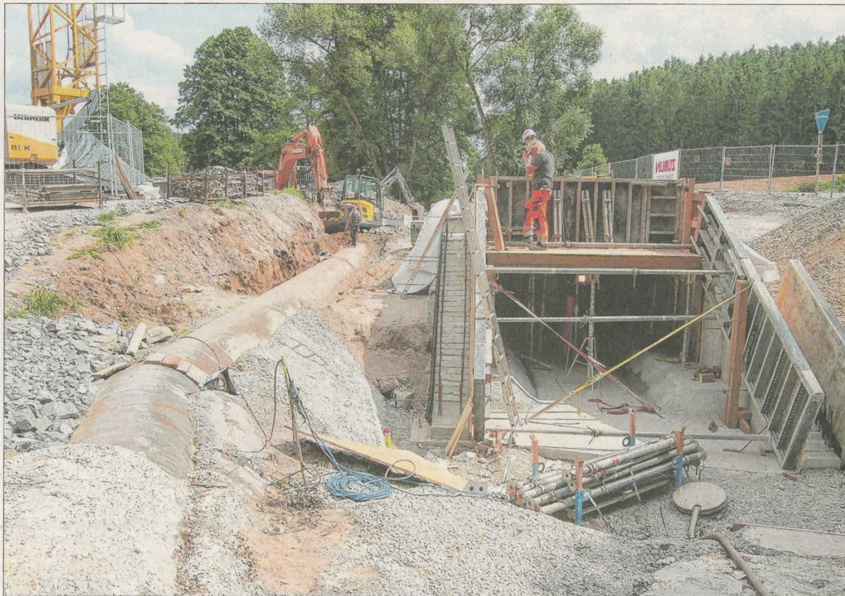
Die Arbeiten an der Brücke über die Steinach bei Mittelsteinach laufen auf Hochtouren. Bis September sollen die Arbeiten abgeschlossen sein. Restarbeiten außerhalb der Verkehrsfläche dauern aber noch etwas länger. Foto: Christa Frühwald
