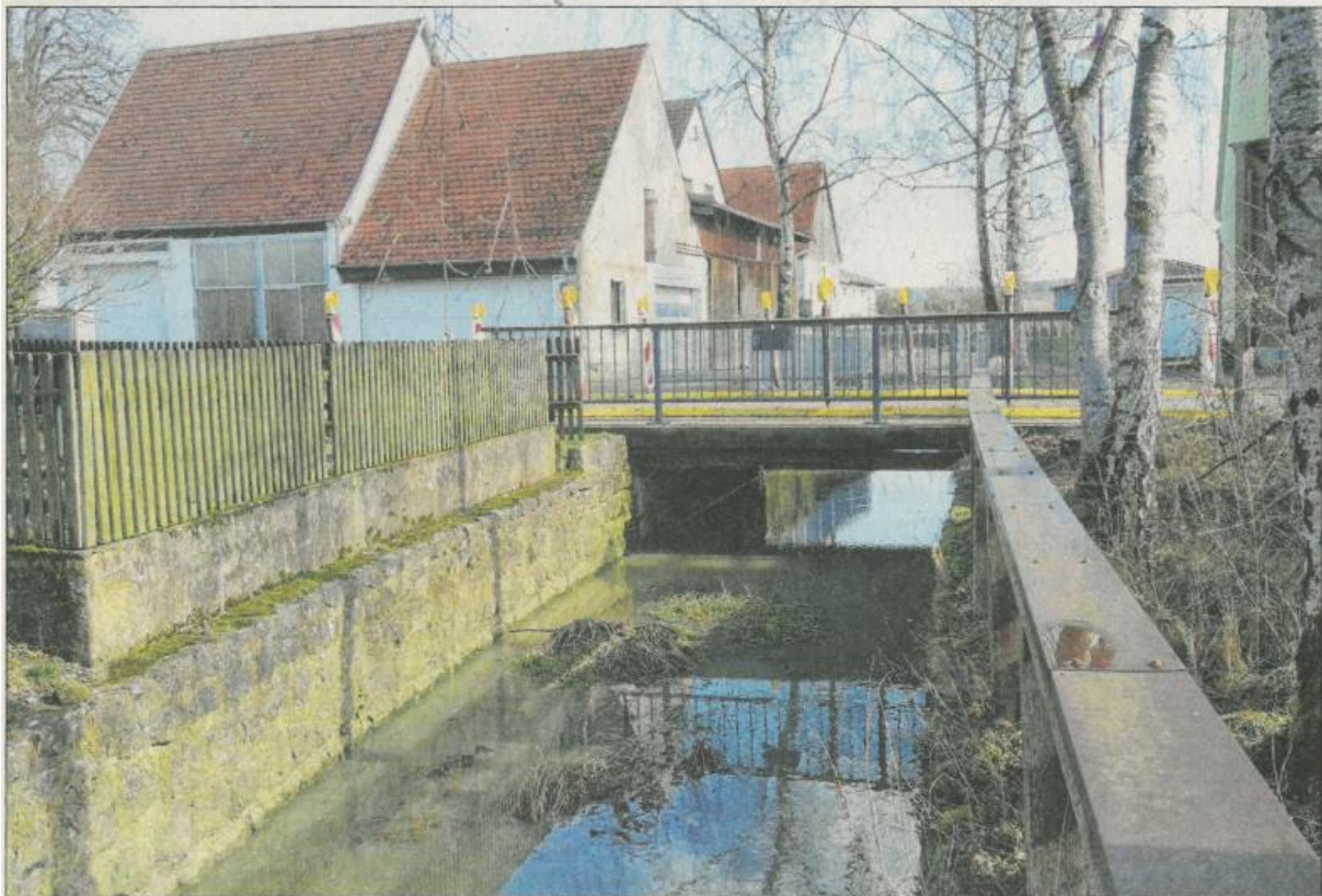
Die Brücke über den Schleifgraben in Schnelldorfs Ortsteil Gailroth ersetzt das Staatliche Bauamt durch einen Neubau. Aus diesem Grund wird die Staatsstraße 2222 ab kommendem Montag gesperrt. Foto: Friedrich Strohmeier
