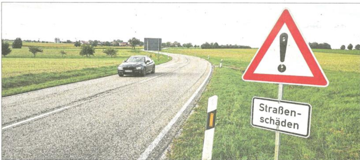
Auf die Schäden, die der Belag der Staatsstraße 2410 aufweist, wird an mehreren Stellen mit Schildern hingewiesen. Das Foto entstand bei Reichelshofen. Am Montag beginnen im Uffenheimer Bereich die Erneuerungsarbeiten. Die Baustelle wird dann sukzessive nach Süden wandern. Foto: Jürgen Binder
