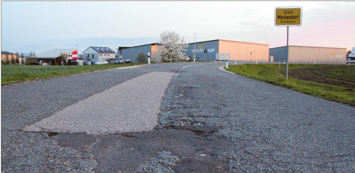
Die Straße zum Gewerbegebiet Energiepark ist in einem miserablen Zustand. Sie soll im Zuge der B13-Sanierung gleich mit in Stand gesetzt werden. Doch dann wäre eine Anfahrt mit dem Lkw mehrere Tage lang nicht möglich. Foto: Robert Maurer
