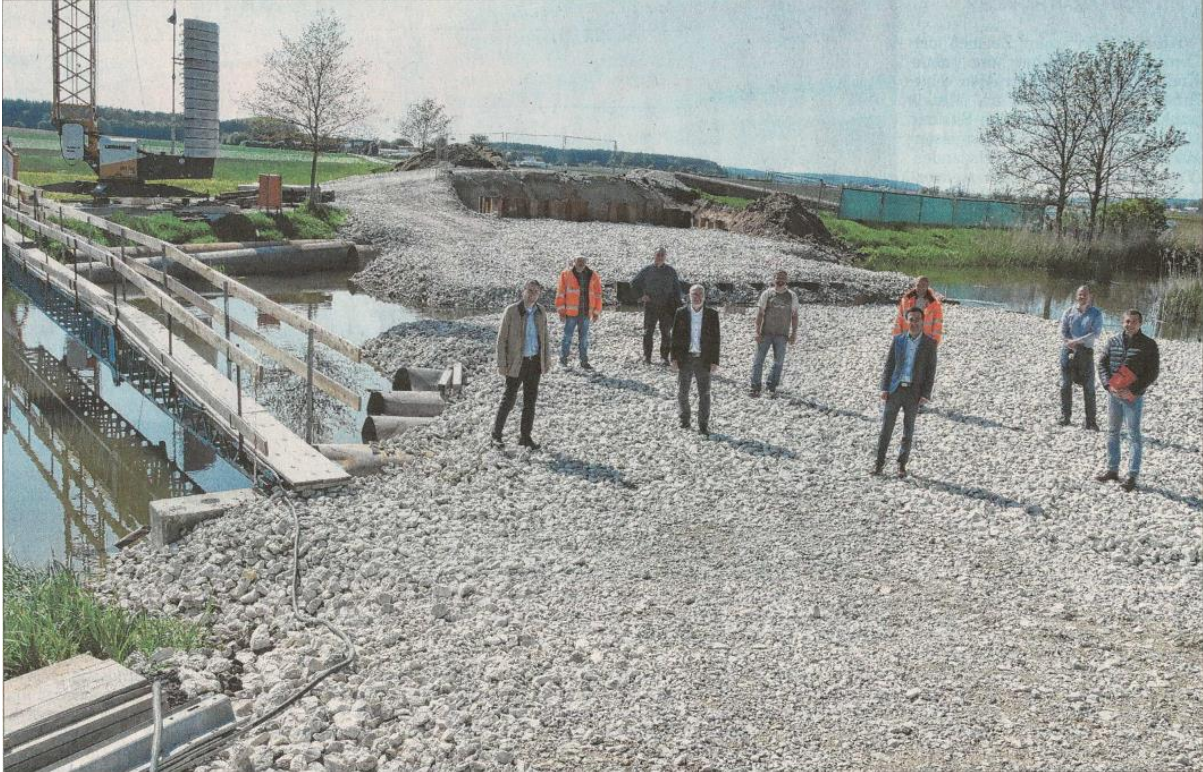
Ortstermin auf der Baustelle bei Oberndorf: Landrat Dr. Jürgen Ludwig (links) und Vertreter der Tiefbauverwaltung des Landkreises, des Staatlichen Bauamtes Ansbach und der ausführenden Firma erläuterten die nächsten Schritte, im Beisein des Ornbauer Bürgermeisters Marco Meier (Dritter von rechts) und dessen Amtskollegen Helmut Schnotz aus Bechhofen. Im Ortsteil Thann ist die Brückenerneuerung 2021 vorgesehen. Foto: Silvia Schäfer
