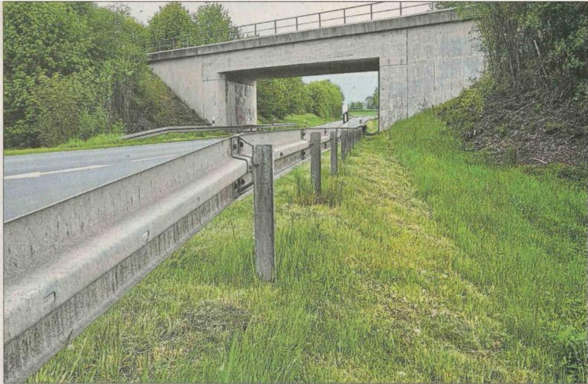
Und es geht doch: Durch die Bahnunterführung bei Wiedersbach passt auch ein Radweg. Das Staatliche Bauamt hat seinen Widerstand aufgegeben, im Herbst soll gebaut werden. Foto: Wolfgang Grebenhof
