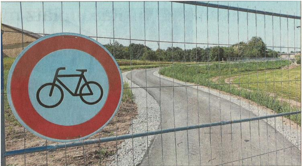
So gut wie fertig, aber derzeit wegen Restarbeiten noch gesperrt: Der neue Radweg-Abschnitt zwischen Leutershausen und dem Stadtteil Wiedersbach wird bald freigegeben. Fotos: Wolfgang Grebenhof
