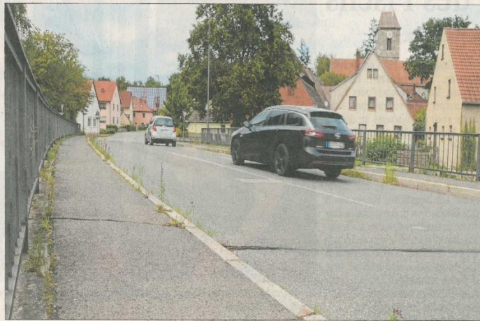
Mitten in Gutenstetten rollt der Verkehr auf der Staatsstraße über die Steinachbrücke. Diese soll 2023 erneuert werden – Kostenpunkt nach ersten groben Schätzungen rund zwei Millionen Euro. Foto: Johannes Zimmermann
