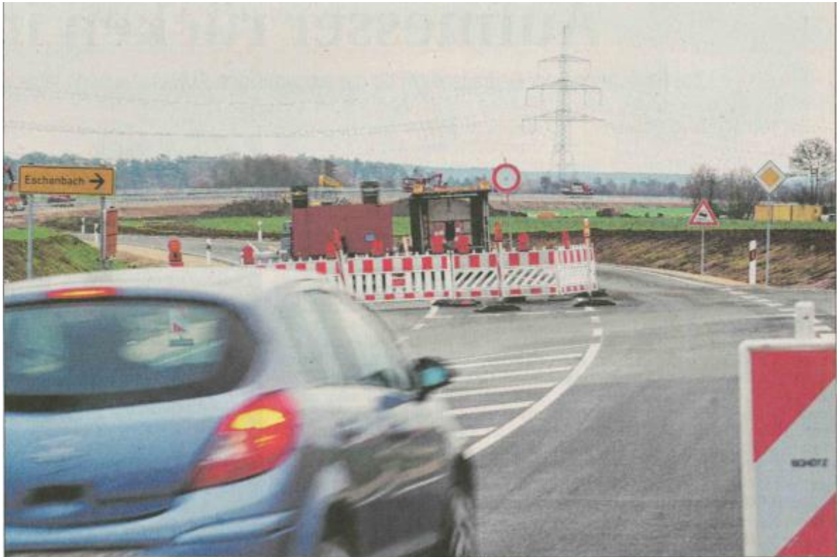
Fast ein halbes Jahr war die Staatsstraße zwischen Markt Erlbach und Wilhermsdorf gesperrt, weil die Ortsumgehung für Eschenbach gebaut wurde. Heute wird die neue Straße freigegeben. Foto: Heinz Wraneschitz
