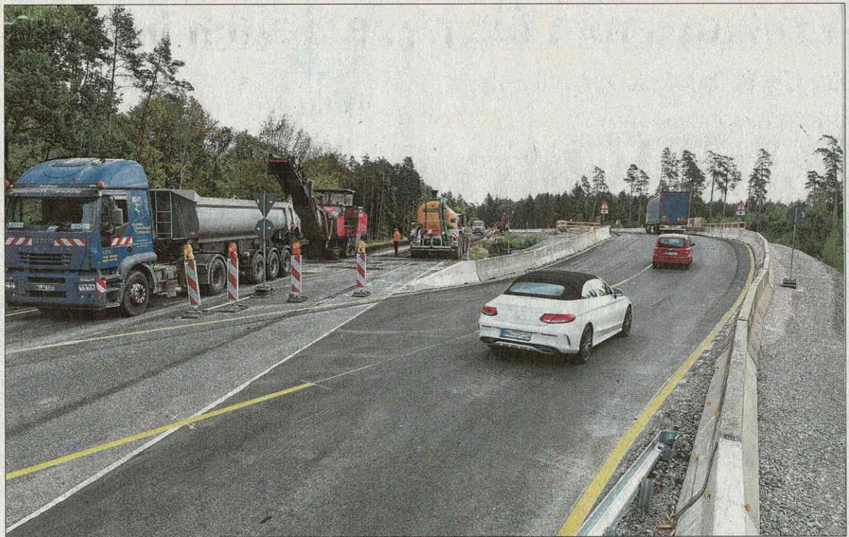
Eigens eine aufwendige Umfahrung ließ das Staatliche Bauamt anlegen, um die Brücke über die Bahnlinie auf der Bundesstraße 14 bei Heilsbronn bei fließendem Verkehr erneuern zu können. Gestern hat der Abbruch des alten Bauwerks begonnen, in einem Jahr soll die neue Überfahrt stehen. Foto: Jim Albright
