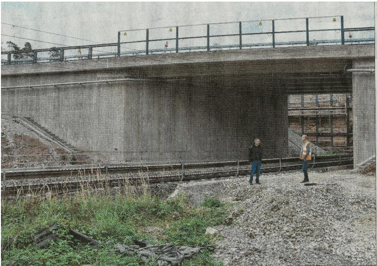
Auf der Baustelle: Ehrgeiziges Ziel ist die Fertigstellung des Brückenbaus noch vor Jahresende. F.: Silvia Schäfer
