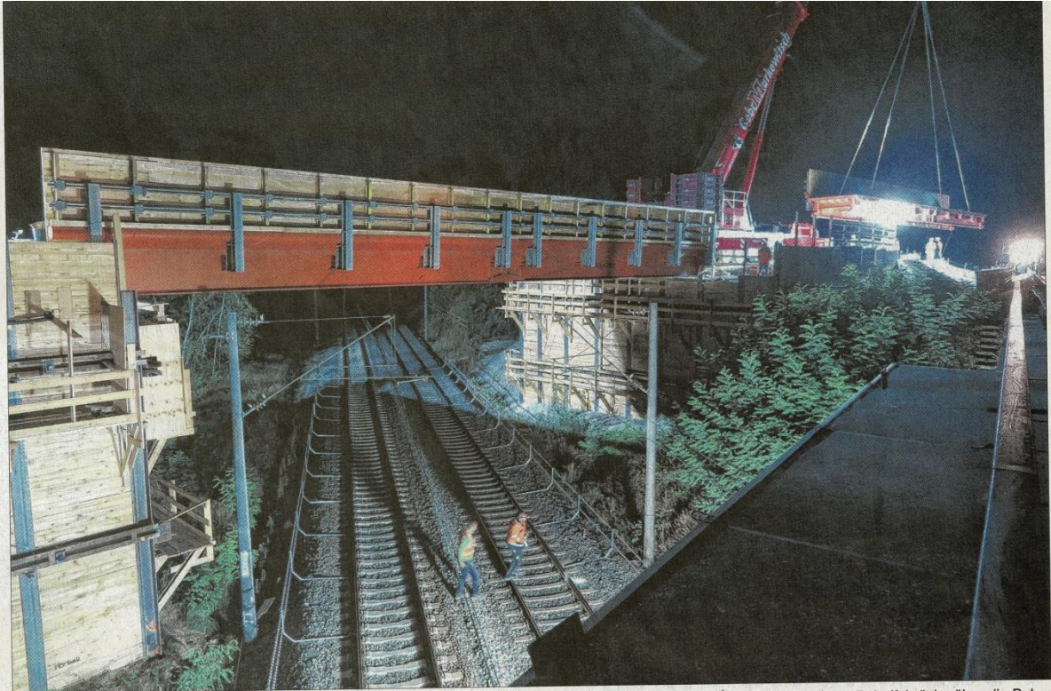
Mehrere Firmen arbeiteten zusammen, als in der Nacht zum Sonntag ein Großkran bis zu 50 Tonnen schwere Bauteile für eine Behelfsbrücke über die Bahnstrecke Ansbach-Nürnberg nahe Heilsbronn einhob. In einem Monat soll darüber der Verkehr auf der Bundesstraße 14 laufen. Foto: Eckard Dürr
