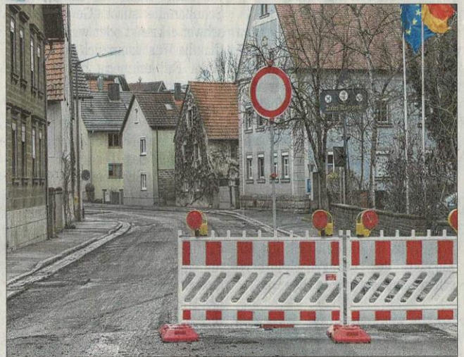
Gestern wurde die Oberickelsheimer Ortsdurchfahrt aufgefräst. Bis Dezember soll die Bundesstraße umfassend saniert werden Foto: Lisa Pauer
