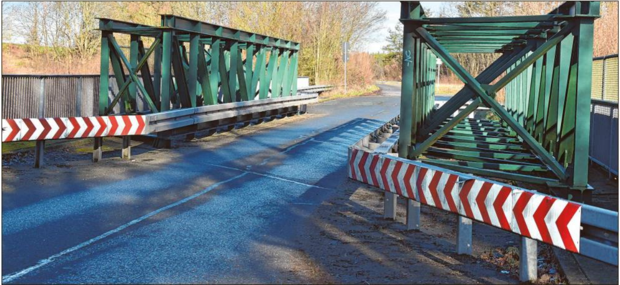
Die marode Wulkersdorfer Brücke würde im Rahmen des höhenfreien Umbaus des Verkehrsknotens Emskirchen-West auch auf Kosten des Bundes erneuert. Für die Gemeinde entstünden keine Kosten. Foto: Ute Niephaus
