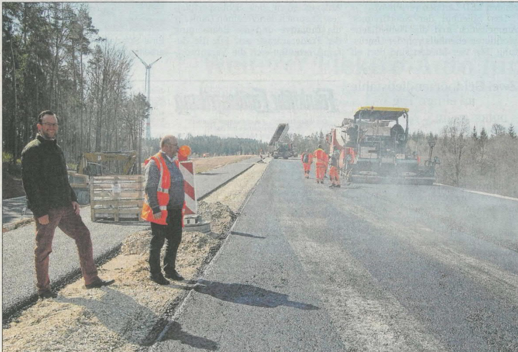
Wilburgstettens Bürgermeister Michael Sommer (links) und Andreas Fechner vom Staatlichen Bauamt Ansbach besichtigten bei einem Ortstermin die Straßenbaustelle bei Greiselbach. Parallel zur Fahrbahn der Bundesstraße verläuft ein Radweg (links im Bild). Foto: Markus Weinzierl
